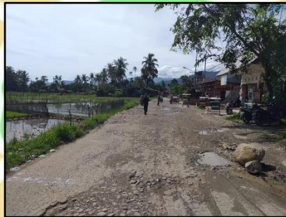
Gambar 1. 1 Kondisi Jalan Balai Baru – Sawah Laing Sumber: Dokumentasi PUPR Kota Padang
