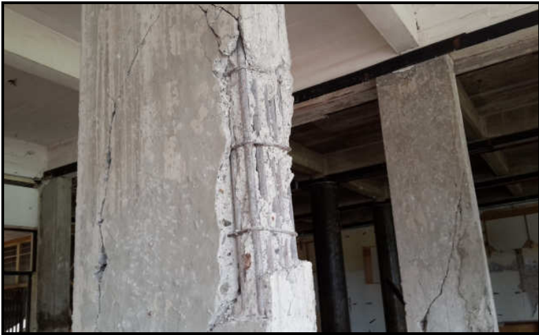
Gambar 1.2. Kerusakan Struktur Kolom
