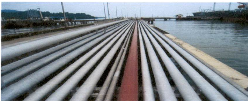
Gambar 2.6 Pipa baja karbon Schedule Grade B ERW di Pertamina BBM di Teluk Kabung jl. Raya Padang-Painan km 24 padang
