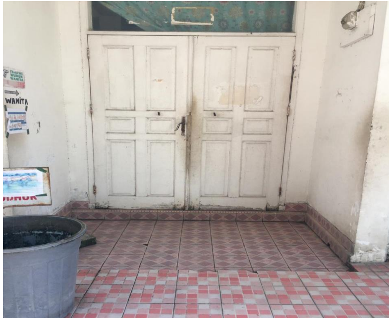
Gambar 1.3 Kondisi Jalan Menuju Toilet dan Tempat Wudhu'
