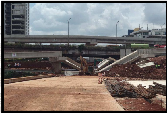
Gambar 1.1 Kecelakaan Pada Balok PCI Girder (Kompas.com)
