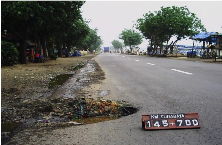
Gambar 1.2 Potholes (lubang) karena adanya genangan air di bawah perkerasan
