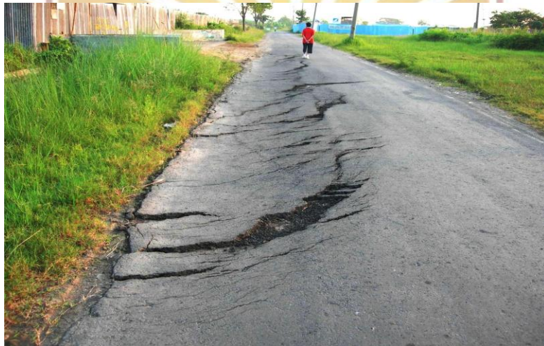
Gambar 1.3 Kerusakan jalan akibat beban kendaraan truk yang terlalu berat
