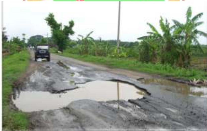
Gambar 1.1 Air hujan yang merembes ke tanah subgrade dan melunakkan tanah subgrade
