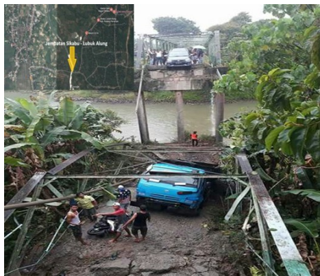
Gambar 1.2 Dokumentasi Jembatan Sikabu Ambruk
