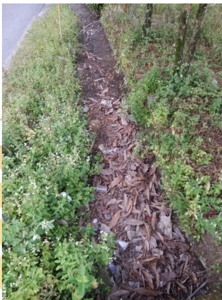
Gambar 4.23 Kondisi Saluran Air Utama Nagari Campago
