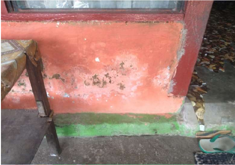
Gambar 4.20 Bagian Rumah Responden yang Mengalami Kerusakan Akibat Banjir
