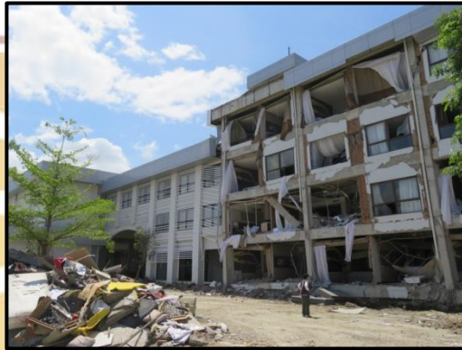
Gambar 1.1 Kerusakan struktur bangunan akibat gempa
