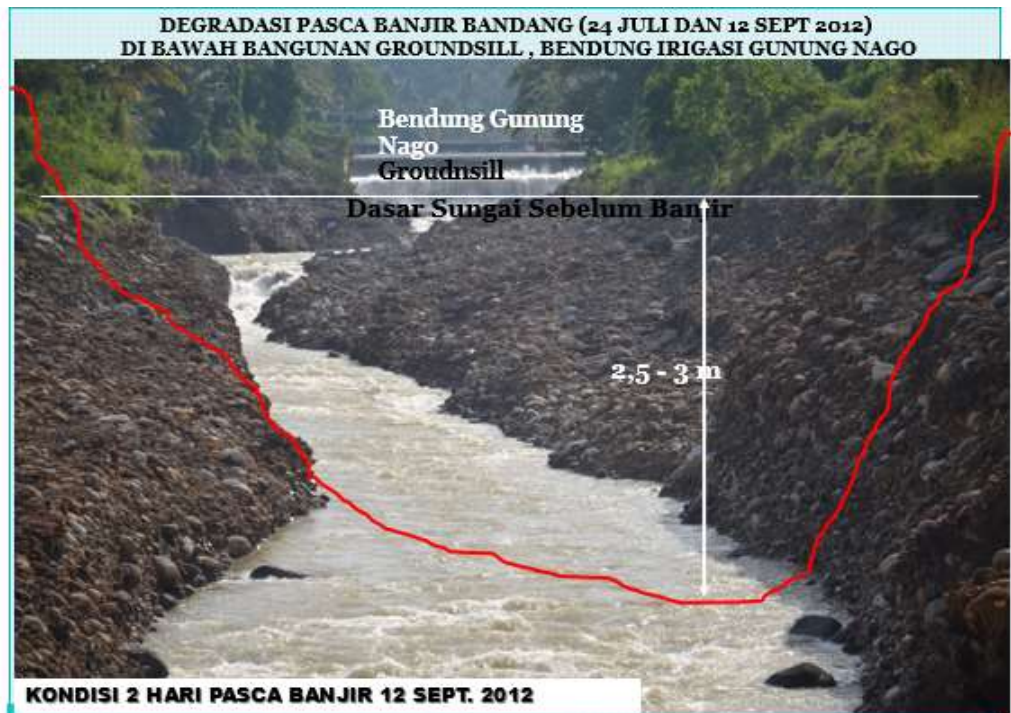
Gambar 1.5 Kondisi Degradasi Dasar Sungai Pasca Banjir 12 September 2012
