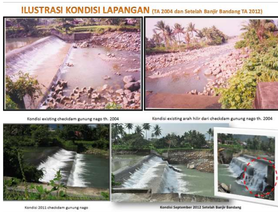
Gambar 1.3 Kondisi Bangunan Checkdam Sebelum dan Setelah Banjir Tahun 2012
