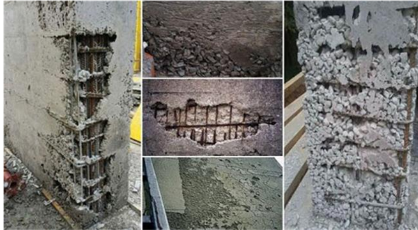
Gambar 1.3 Segregasi Pada Struktur Bangunan
