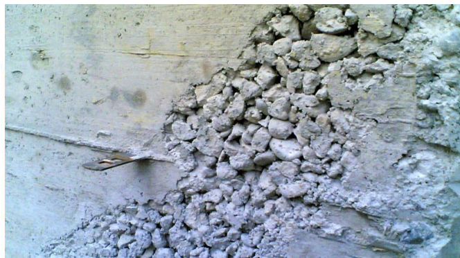
Gambar 1. 3 Segregasi pada Struktur Bangunan
