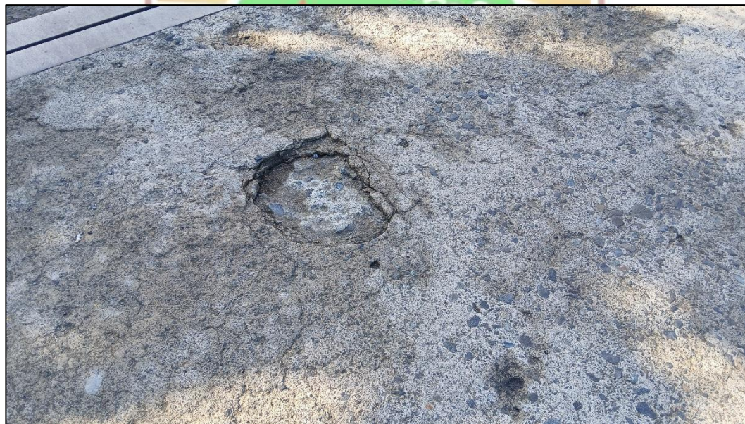
Gambar 29. Permukaan Lantai Berlubang Pada Sistem Lantai (NK.1)
