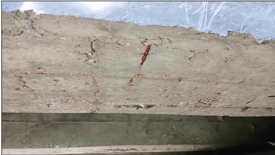
Gambar 22. Karat Baja Tulangan Pada Gelagar Utama Memanjang (NK.2)
