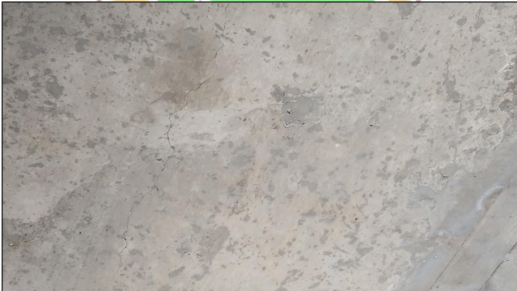
Gambar 25. Retak Pada Pelat Lantai (NK.2)
