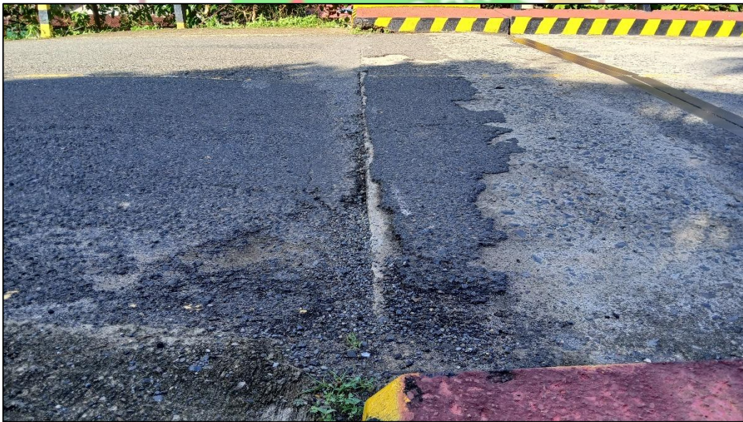
Gambar 14. Perkerasan Berlubang pada Perkerasan Jalan Pendekat
