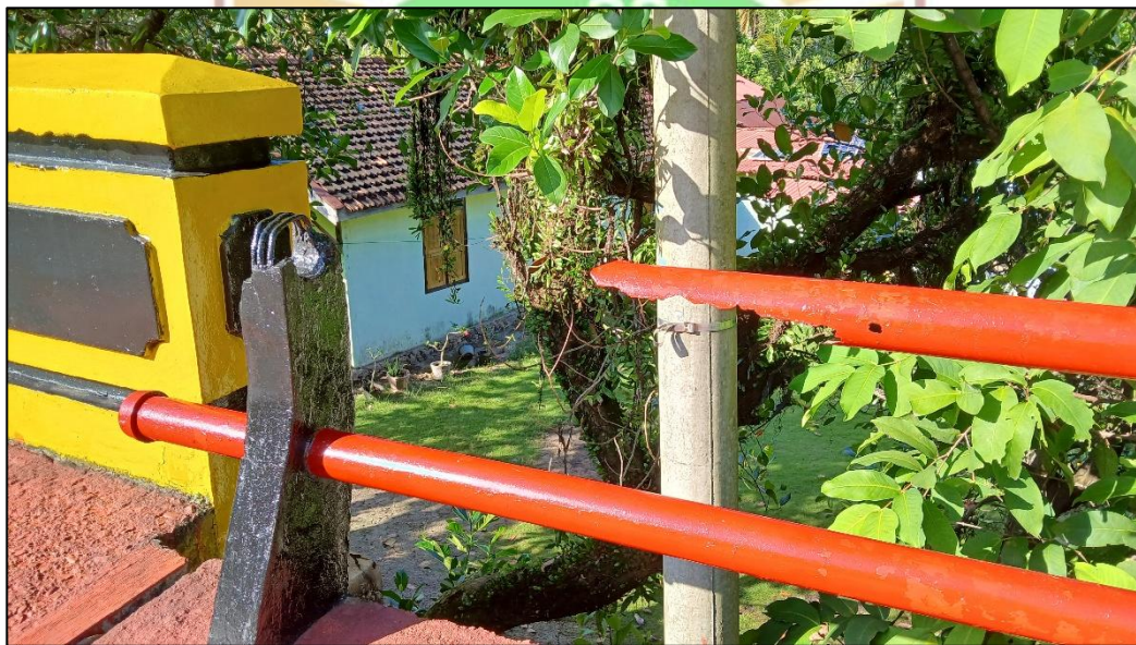
Gambar 31. Pecah atau Hilangnya Bahan Pada Tiang Railing (NK.1)
