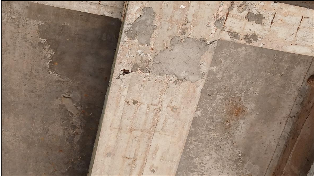
Gambar 20. Beton Kropos Pada Gelagar Utama Memanjang (NK.2)
