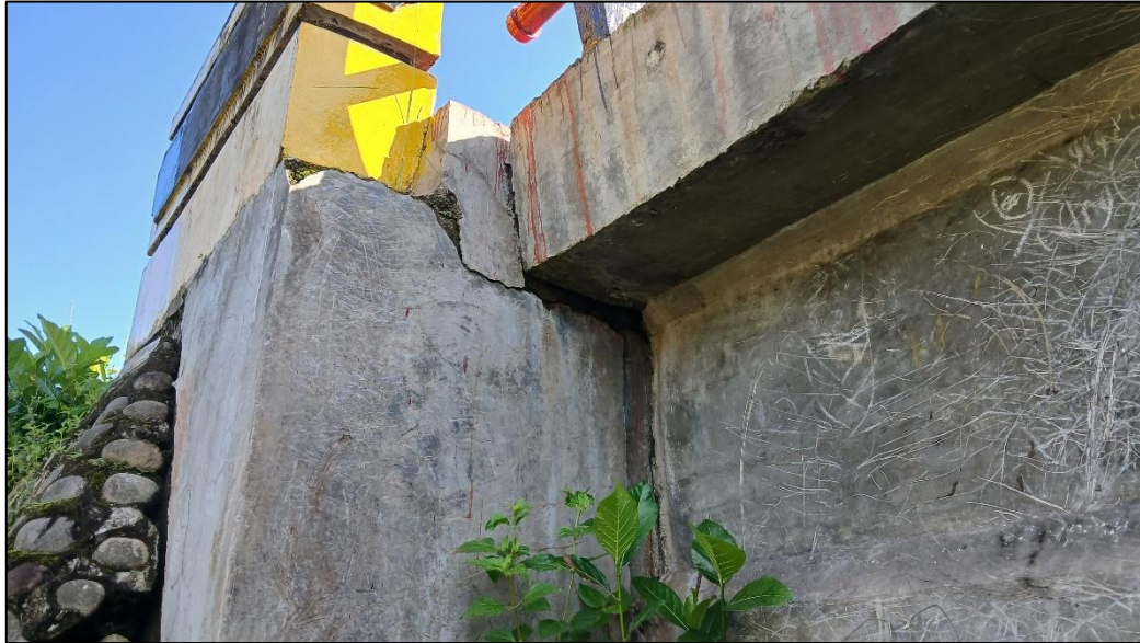
Gambar 19. Retak Elemen Beton Pada Tembok Kepala Jembatan (NK.2)
