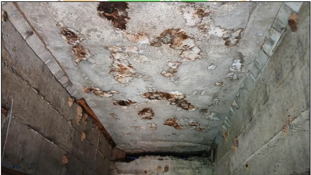
Gambar 27. Pelapukan Beton Pada Pelat Lantai (NK.2)
