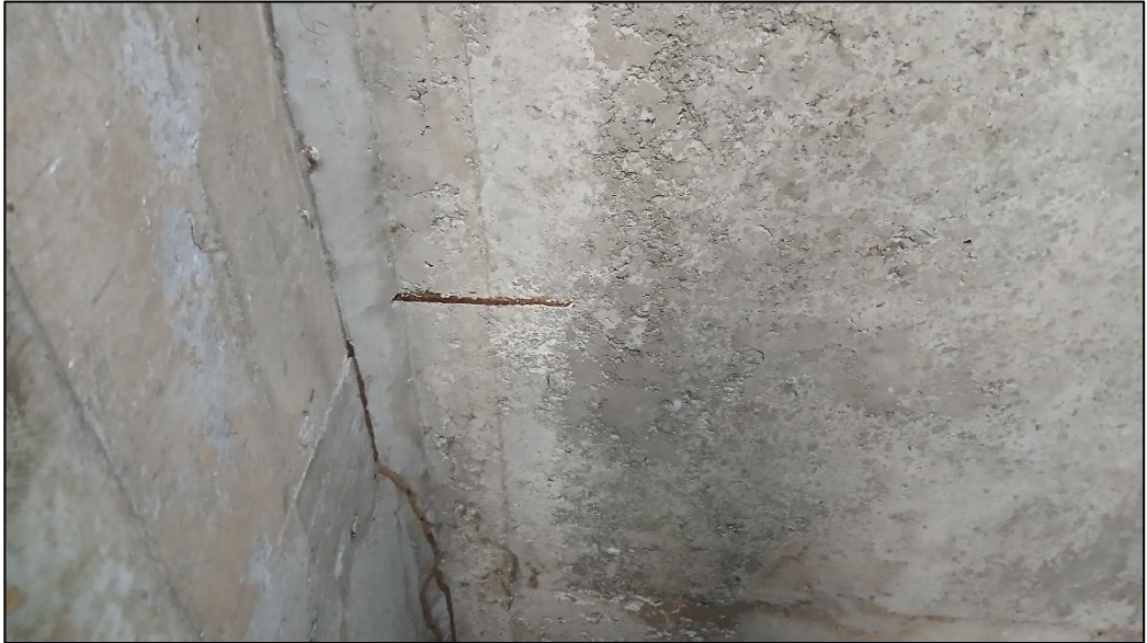
Gambar 26. Karat Baja Tulangan Pada Pelat Lantai (NK.2)
