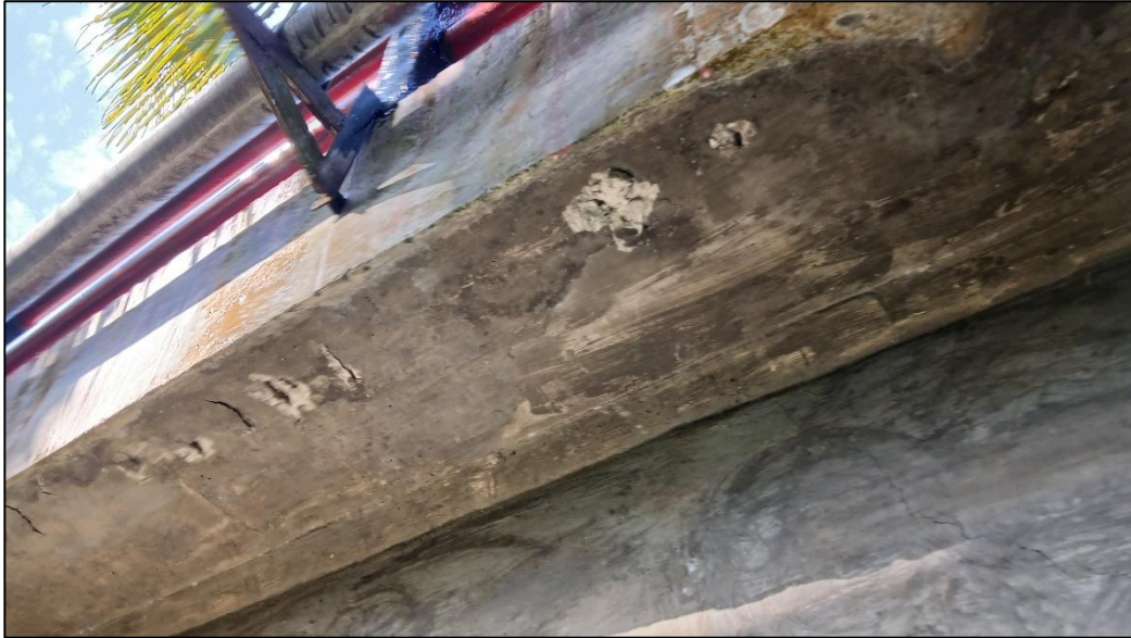
Gambar 24. Beton Kropos Pada Pelat Lantai Beton (NK.2)
