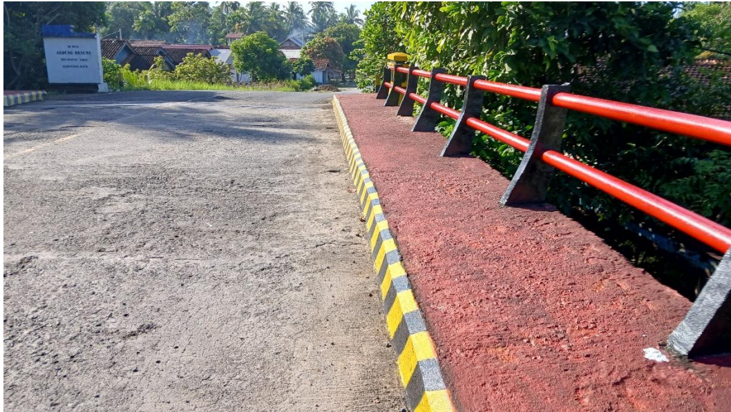
Gambar 28. Pipa Cucuran Pada Drainase Lantai Tersumbat (NK.3)
