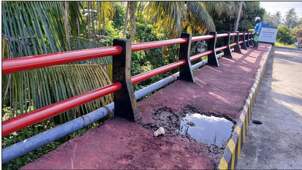
Gambar 30. Pecah atau Hilangnya Bahan Pada Trotoar (NK.1)
