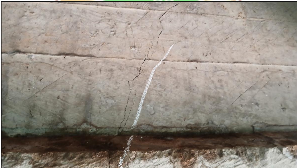
Gambar 21. Retak Pada Gelagar Utama Memanjang (NK.3)
