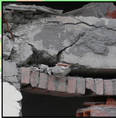
Gambar 1.1 Kerusakan struktur balok akibat gempa
