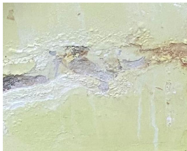
Gambar 1.2 Kondisi Dinding di Ruang NICU RS UNAND
