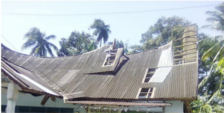
Gambar 1.2 Kerusakan pada Konstruksi Atap Bagonjong
