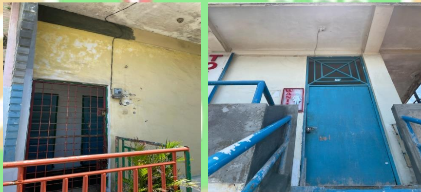
Gambar 1.5 Kondisi toilet di pantai Padang
