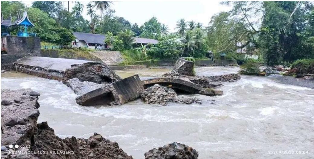
Gambar 1.2 Bendung Lubuak Sikoci runtuh akibat Banjir di Kecamatan 2x11 Enam Lingkung (Sumber: Google, 2022)
