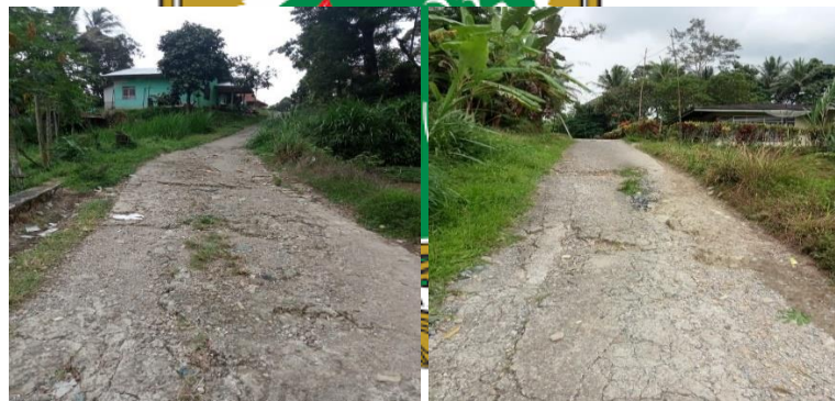
Gambar 1.1 Kondisi Jalan di Jorong Balai Badang Gadang Bawah
