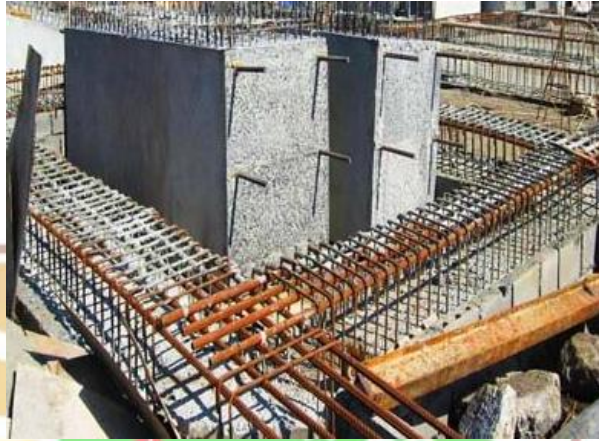
Gambar 1.1 Korosi pada baja tulangan
