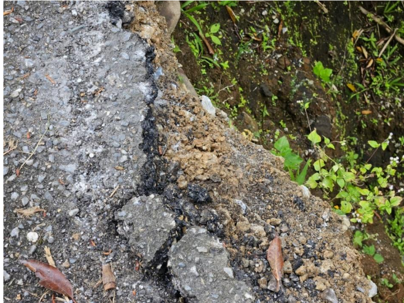
Gambar 1.1 Jalan Rusak di Nagari Andaleh sebagai Agregat RAM
