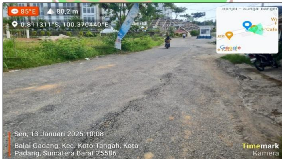
Gambar 1. 1 Deformasi Gelombang pada Struktur Perkerasan Fleksibel di Wilayah Kampus UIN Imam Bonjol Padang
