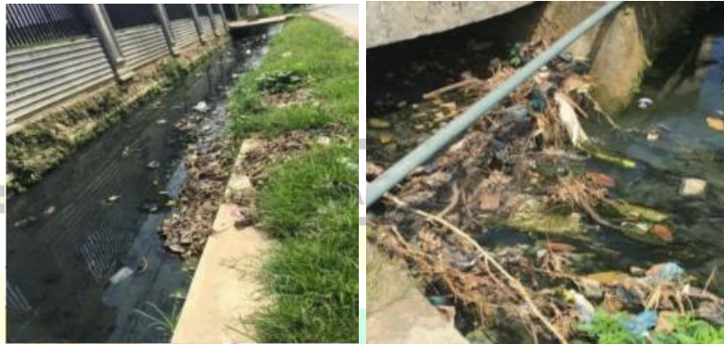
Gambar 1. 2 Saluran Drainase yang Tersumbat di Kota Padang
