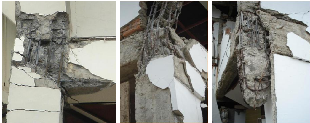
Gambar 1.1 Kegagalan akibat tidak adanya tulangan sengkang kolom pada hubungan balok-kolom beton bertulang pada Gedung Samsat Provinsi Sumbar (sumber : http://www.wm-site.com/civil-eng/short-course-haki-komda-bali-2010 )
