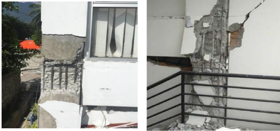
Gambar 1.2 Tidak adanya tulangan sengkang kolom pada hubungan balok-kolom beton bertulang pada bangunan terdampak Gempa Sulawesi (sumber : Irsyam dkk, 2018)
