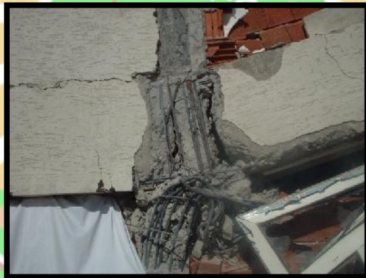
Gambar 1.2 Sambungan Balok-Kolom Tidak Memiliki Tulangan Geser (Sumber : http://db.concretecoalition.org/static/data/4-illustration-of-damage.html )
