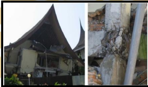
Gambar 1.3 Kondisi Bangunan Akibar Gempa Padang (Sumber : Yuebing Li dan Yasushi Sanada. (2014))
