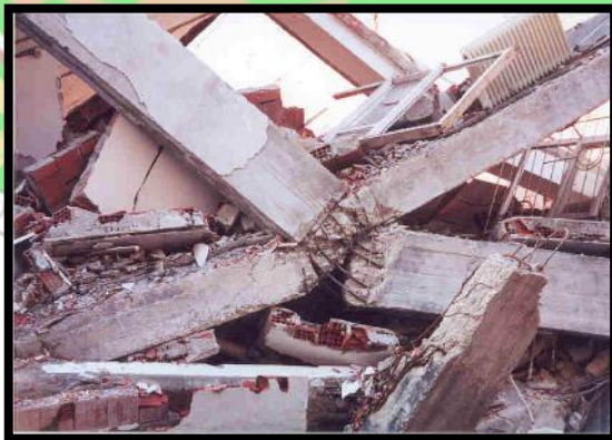
Gambar 1.1 Keruntuhan Pada Sambunga Balok-Kolom (Sumber : http://www3.nd.edu/~concrete.html )
