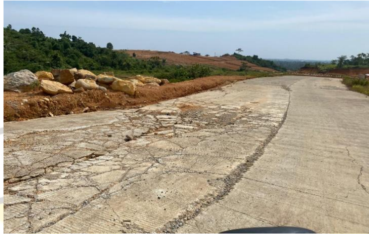
Gambar 1. 4 Keretakan Pada Perkerasan Kaku di Jalan Kampus III UIN Imam Bonjol
