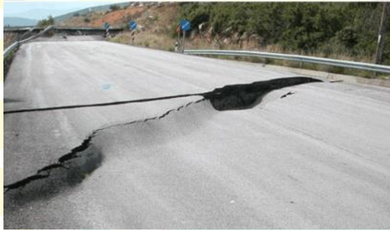
Gambar 1. 1 Kerusakan Pada Perkerasan Jalan Akibat Tanah Ekspansif (Amakye & Abbey, 2021)
