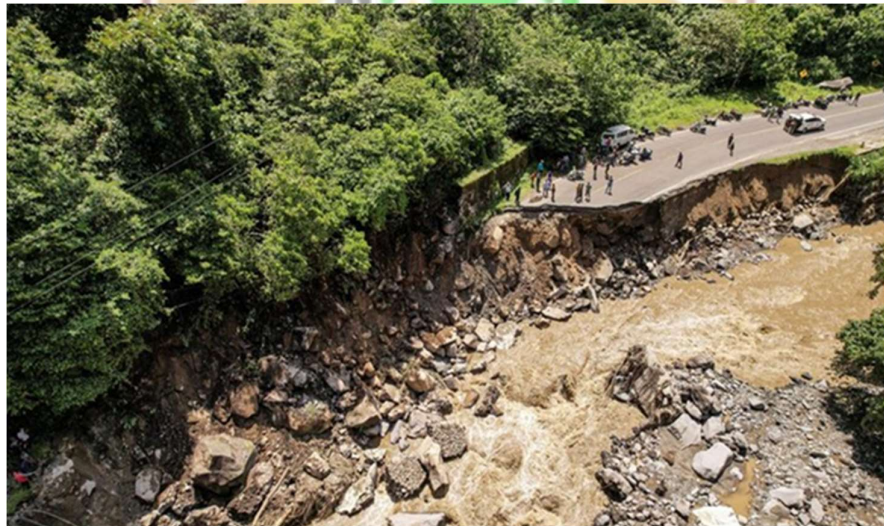
Gambar 1.1 Foto Udara Kondisi Jalan Nasional yang Putus Di Kawasan Silaiang, Tanah Datar Sumatera Barat (Saddam et al., 2025)
