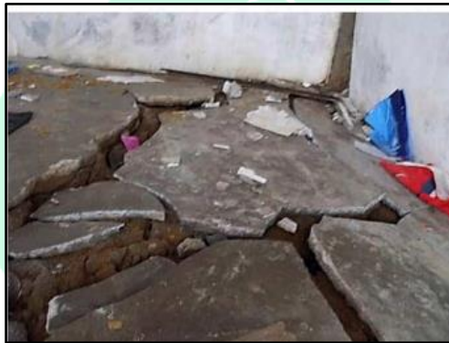
Gambar 1. 3 pergeseran pelat lantai akibat likuifaksi di Desa Perumdam, Padang.
