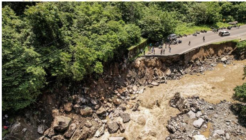
Gambar 1. 1 Foto udara kondisi jalan nasional yang putus di Kawasan Silaiang, Tanah Datar Sumatera Barat
