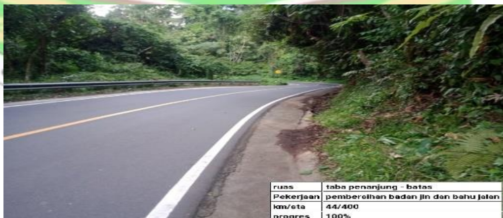
Gambar 5.1.1 Badan jalan bebas hambatan dan kotoran
