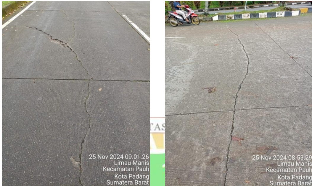
Gambar 1.1 Retak pada perkerasan kaku (a) retak memanjang, (b) retak melintang
