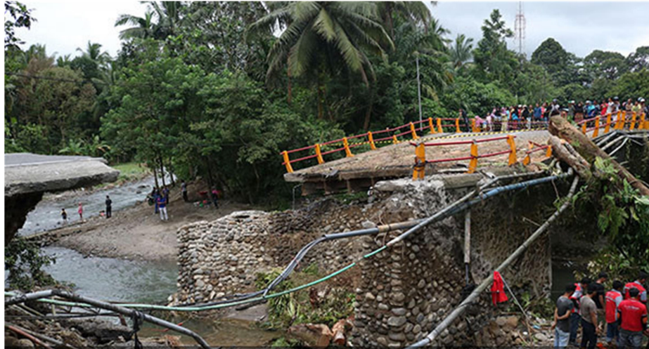
Gambar 1. 1 Kerusakan Jembatan Penghubung Padang - Bukittinggi di KM 54 Kayu Tanam
