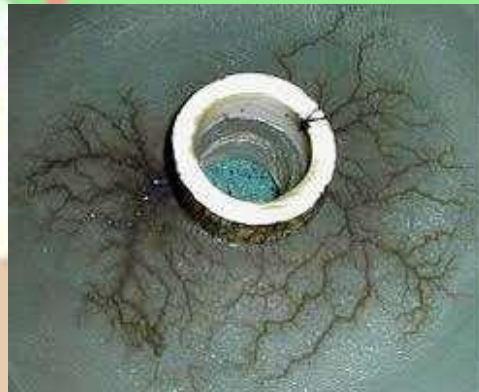
Gambar 4. 10 Isolator yang Mengalami Surface Tracking
