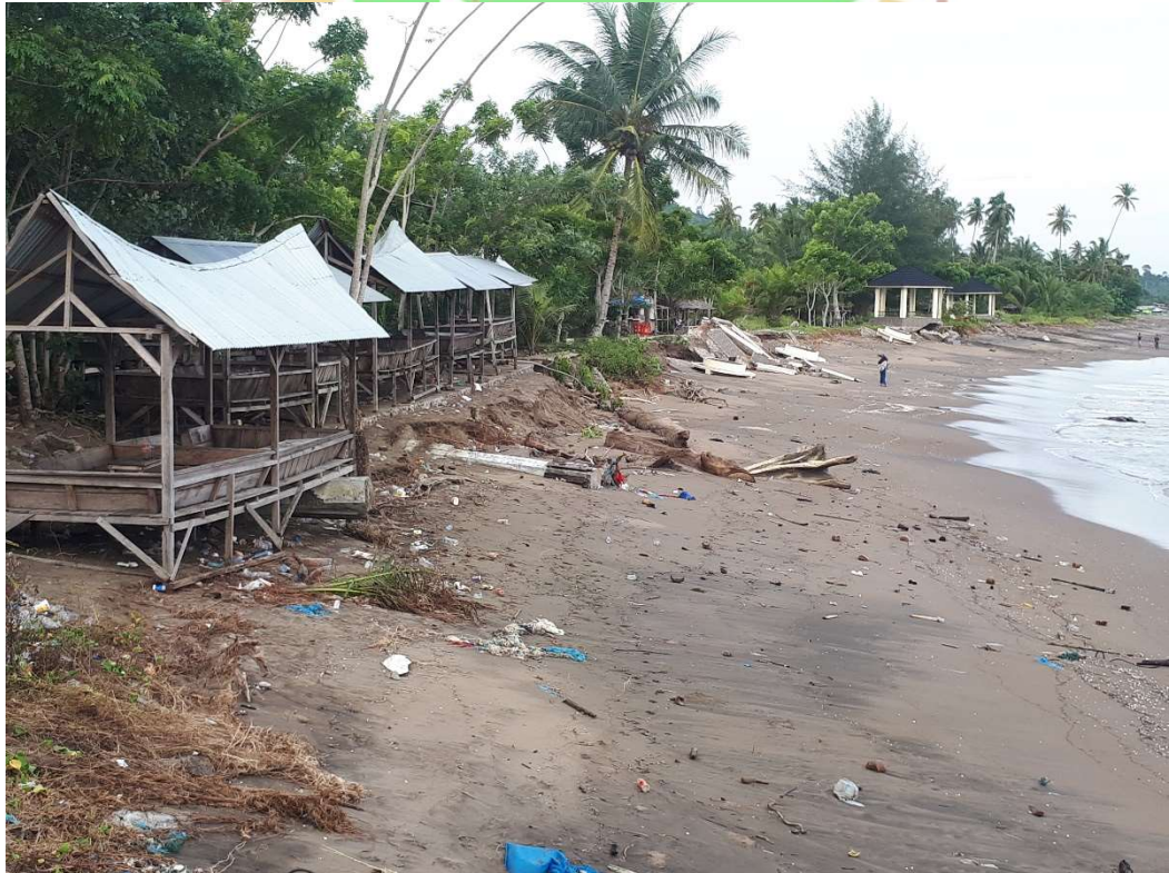
Gambar 1.3 Bangunan rusak akibat abrasi (Gambar diambil pada 9 Juni 2020)
