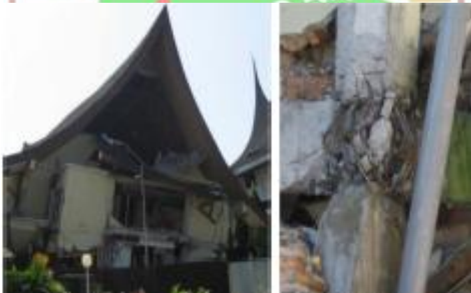
Gambar 1. 4 Kondisi Bangunan Akibat Gempa Padang (sumber: Li, 2014)
