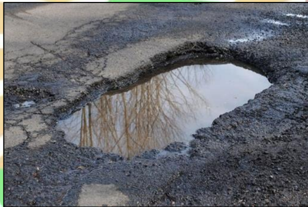
Gambar 1. 1 Kerusakan pada Jalan
