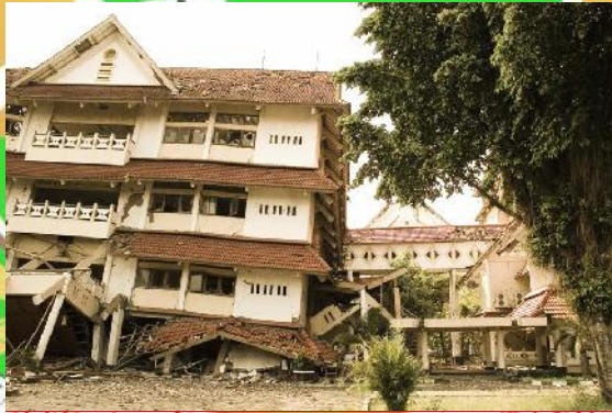
Gambar 1.1 Kerusakan gedung akibat gempa bumi
