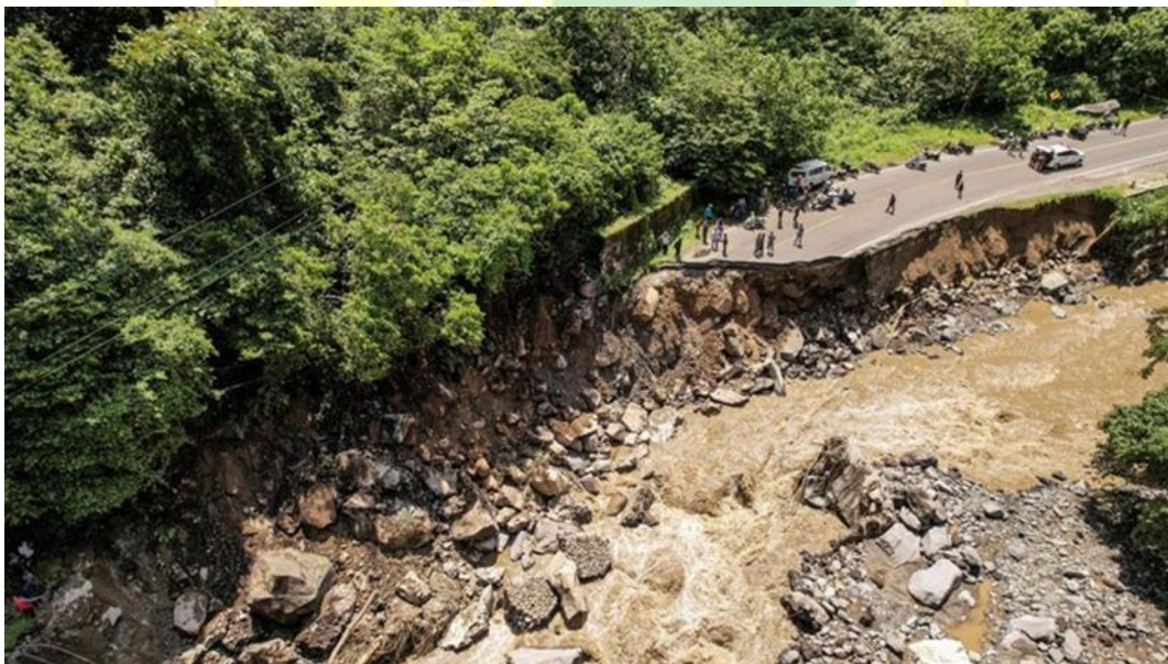
Gambar 1. 1 Foto udara kondisi jalan nasional yang putus di Kawasan Silaiang, Tanah Datar Sumatera Barat ( https://news.detik.com/foto-news/d-7337395/potret-sebelum-dan-sesudah-lembah-anai-diterjang-banjir-bandang )
