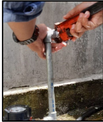
Gambar 3. 10. Pemasangan Alat Manometer
