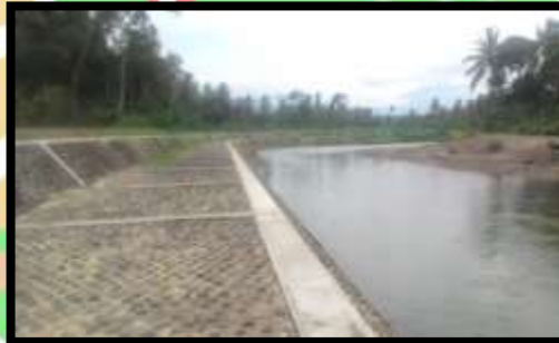
Dok. Arah Timur Bangunan Pengendali Banjir Sungai Batang Nareh
