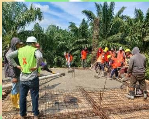
Pelaksanaan Pengecoran Balk Dan Plat lantai Dua Mutu Beton K. 250 Beton Ready Mix
