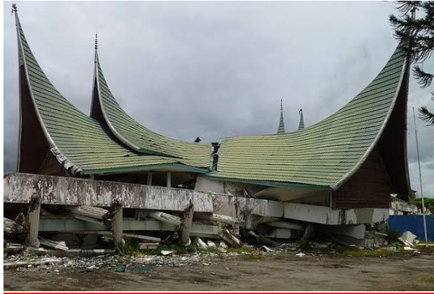
Gambar 1-4 Gedung Pemerintahan Amblas Akibat Gempa Padang
