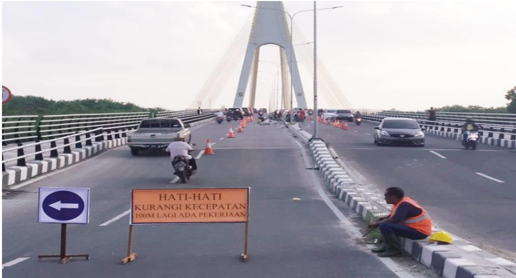
Gambar 1.2 Oprit jembatan Siak IV yang mengalami penurunan
