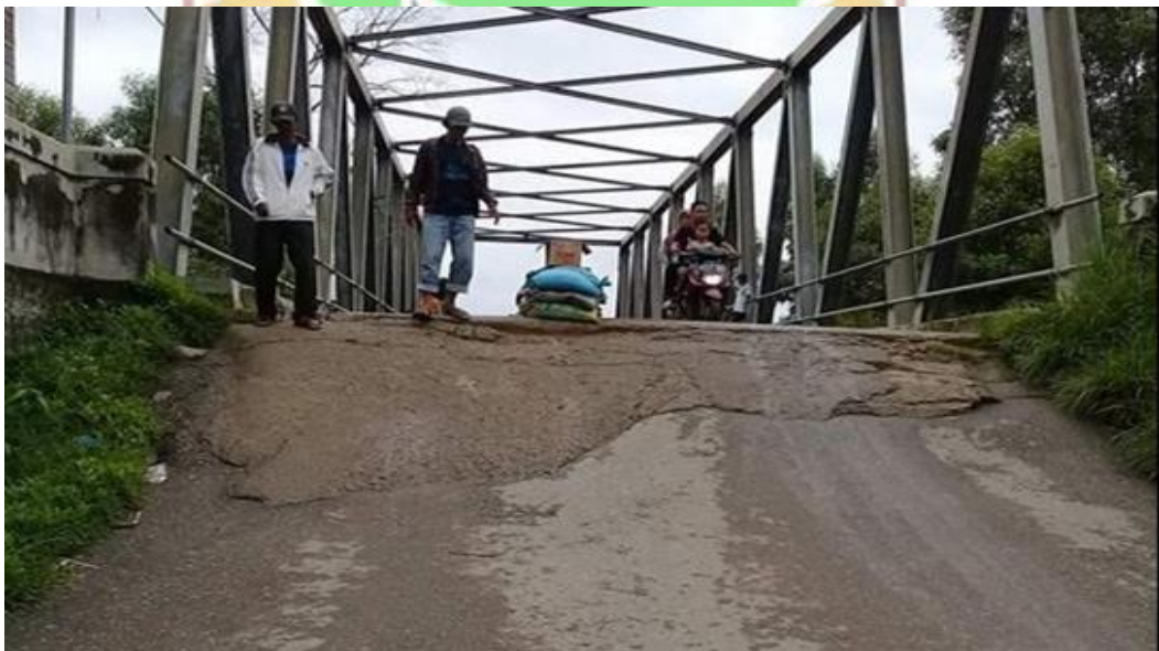
Gambar 1.4 Oprit jembatan Tembilahan yang mengalami penurunan
