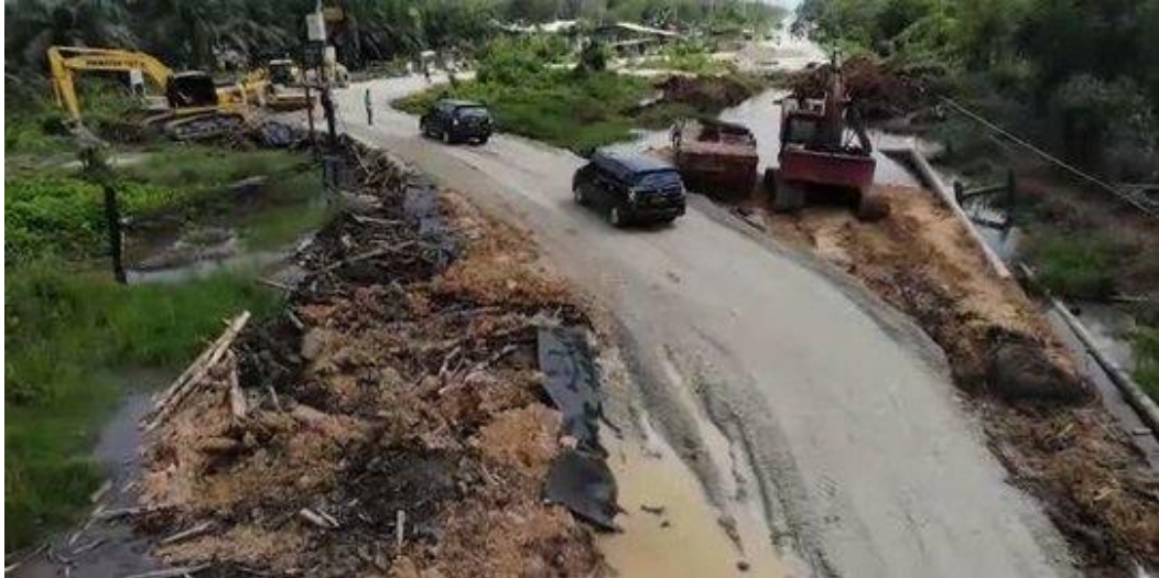
Gambar 1.1 Jalan Siak – Buton yang amblas 2019
