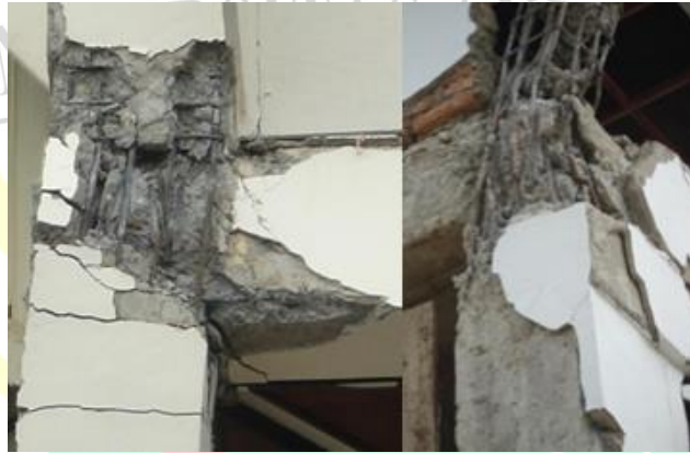
Gambar 1.2 Kegagalan akibat tidak adanya tulangan sengkang pada join balok kolom beton bertulang pada Gedung Samsat Provinsi Sumatra Barat. (sumber : http://www.wm-site.com/civil-eng/short-course-haki-komda-bali-2010 )
