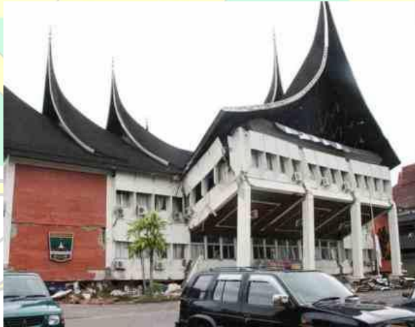
Gambar 1.1 Kegagalan struktur akibat bencana alam pada Gedung Samsat Provinsi Sumatra Barat (sumber : http://www.wm-site.com/civil-eng/short-course-haki-komda-bali-2010 ).
