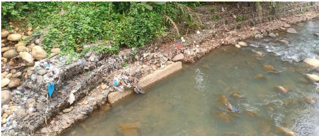
Gambar 1.3 Kerusakan struktur bronjong di sungai Batang Arau
