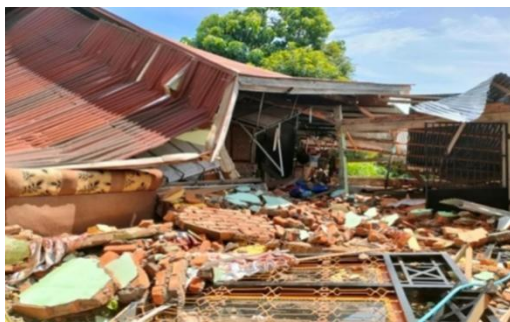
Gambar 1. Dinding Bata Merah Rusak Berat akibat Gempa Pasaman 2022
