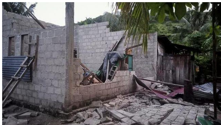
Gambar 1. Rumah tembokan rusak karena gempa
