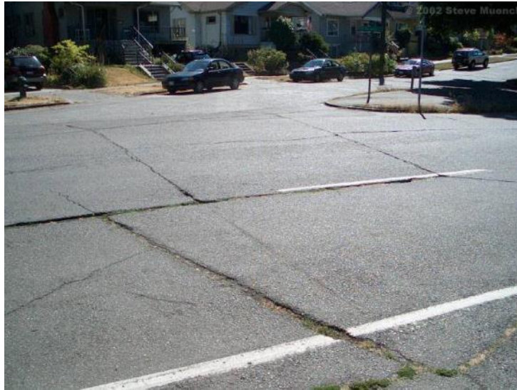
Gambar 1.7 Retak Reflektif (Joint Reflection Cracks)
