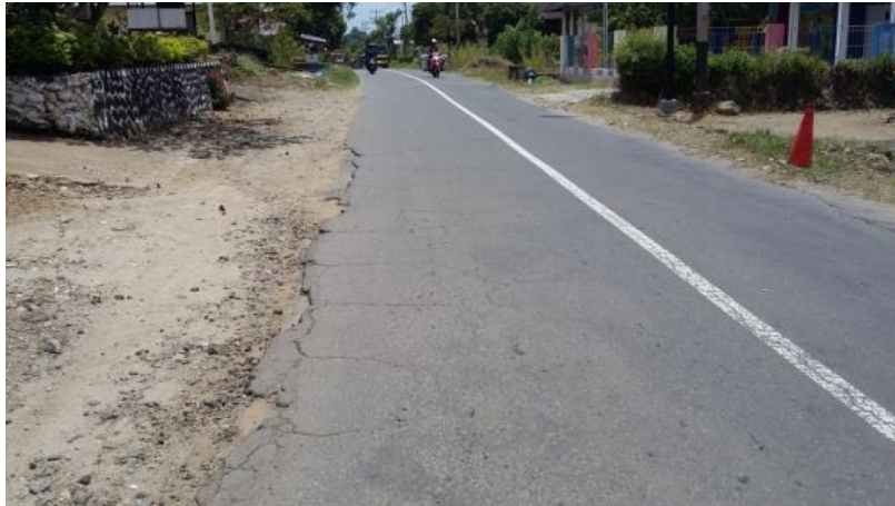
Gambar 3.4 edge cracking (retak tepi) (7H)
