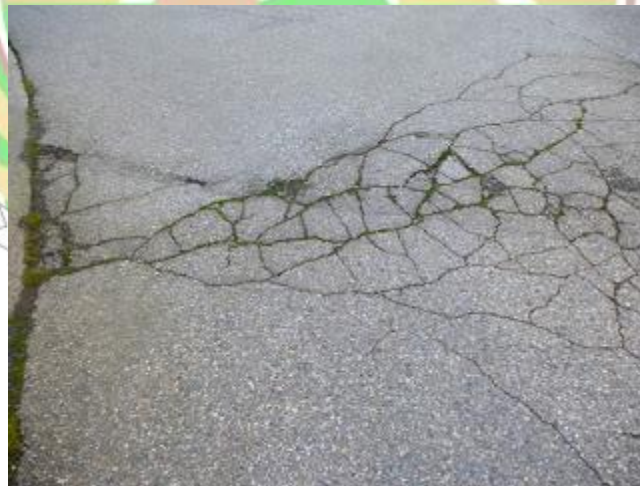
Gambar 1.8 Retak Kulit Buaya ( Alligator Cracks )
