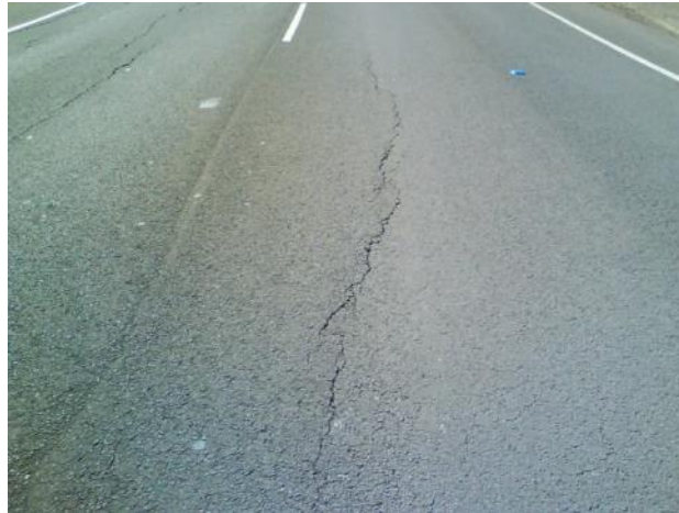
Gambar 1.5 Retak Memanjang (Longitudinal Crack)
