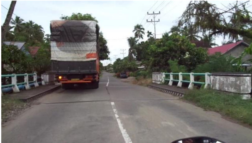
Gambar 3.28 Kendaraan berat yang melewati ruas Jalan Panti – Simpang Empat, salah satu penyebab kerusakan jalan retak tepi.
