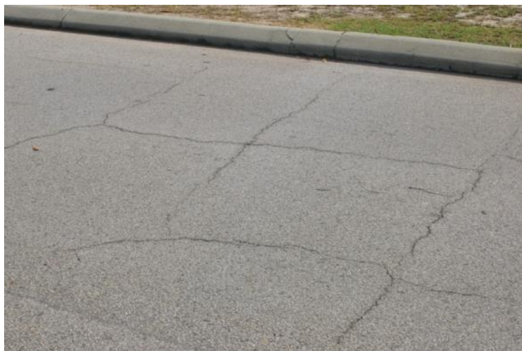
Gambar 1.9 Retak Blok (Block Cracks)
