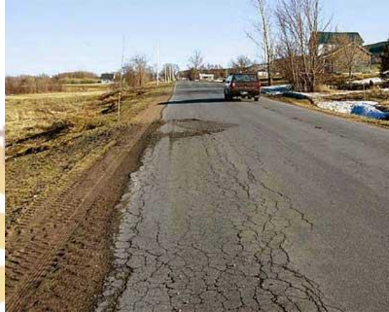
Gambar 1.11 Retak Pinggir (Edge Cracking)
