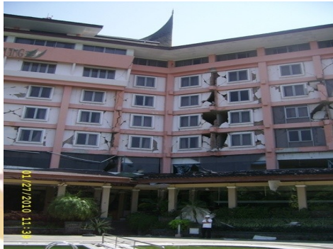
Gambar 1.1 Kerusakan Gedung akibat gempa
